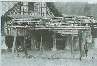
Das Schutzdach für Klawferscheiter mit den schiefstehenden Stützen.
